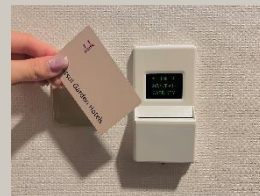
キーポケット キーコンセントにルームキーを 差し込むことで電気が点きます
